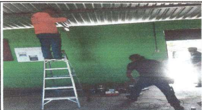
Foto 7: En la siguiente fotografía del establecimiento se muestra los cables retirados del sistema eléctrico de las aulas del establecimiento.
